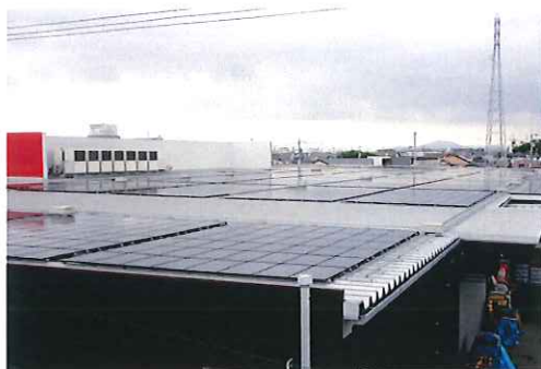
▲豊橋市内ジャンボエンチョー屋上太陽光発電パネル
